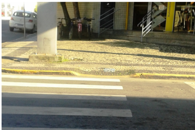
Figura 17.11 - Rebaixamento da calçada na esquina da Rua Cel Jeremias Muniz - Centro.
